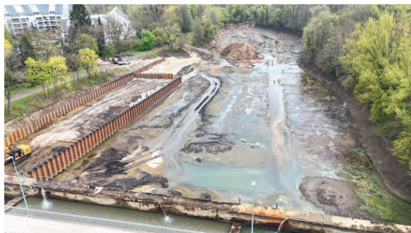
Blick auf den Spundwandkasten sowie den Sandfang (Copyright Wasserwirtschaftsamt Nürnberg)
