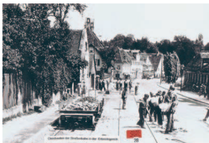
Abb. 2: um 1900 Gleisbauarbeiten für die Straßenbahn beim Gasthof „Goldener Stern“. Privatsammlung H. Wolf
